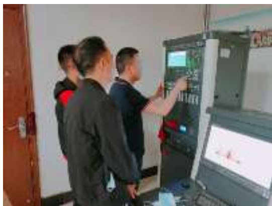
2021.6.3 消防主机操作检查
